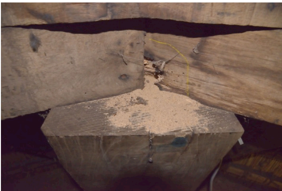
Aantasting van de bonte knaagkever in het eikenhouten boventafelement van de Walderveense molen
